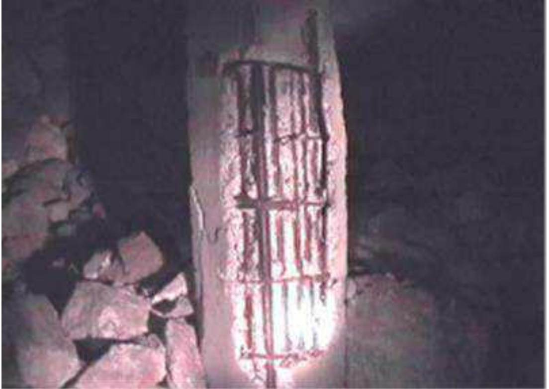
YANAL DEFORMASYON GÖSTERMİŞ KOLON
