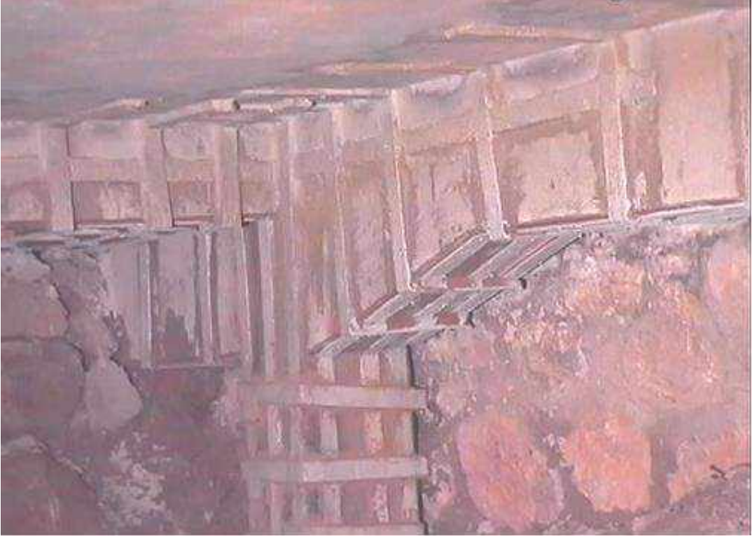
1A KOLONUNDAKİ STATİK TAKVİYE
